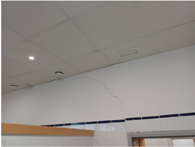
La misma fisura, pero en la en la otra cara del tabique. (inclinada a 45 ° sobre dintel de puerta de entrada a aseo masculino).
