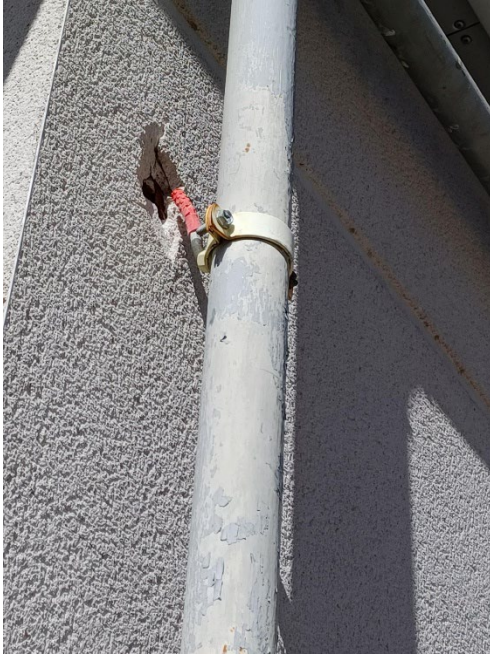
Deterioros producidos en el exterior.
