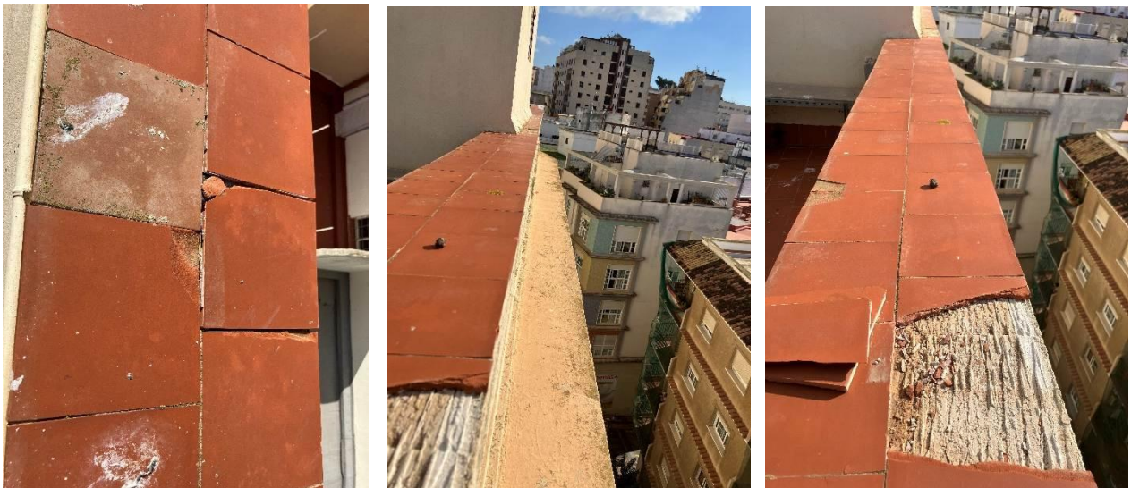
Detalle de la albardilla de petos de cubierta sin rejuntado, levantados y con piezas sueltas con riesgo de caída a acerado.
