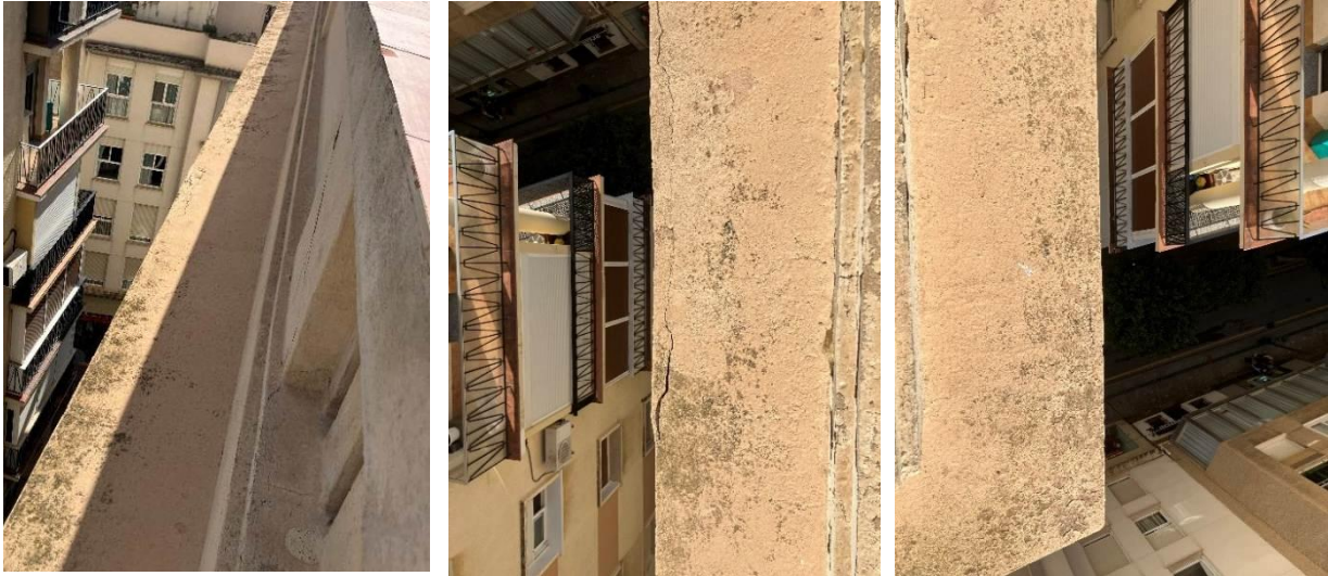
Detalle de cornisa fisurada
