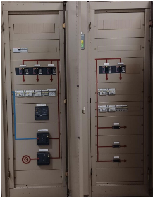
Módulos 5 y 6 (Conmutación red/grupo)
