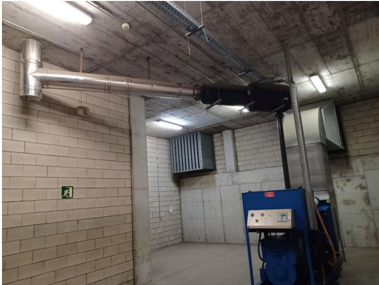
Vistas grupo electrógeno actual
